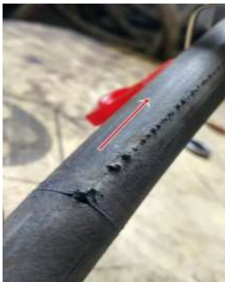
Рис. 1. Повреждение изоляции электрического кабеля (разломы, порезы)
