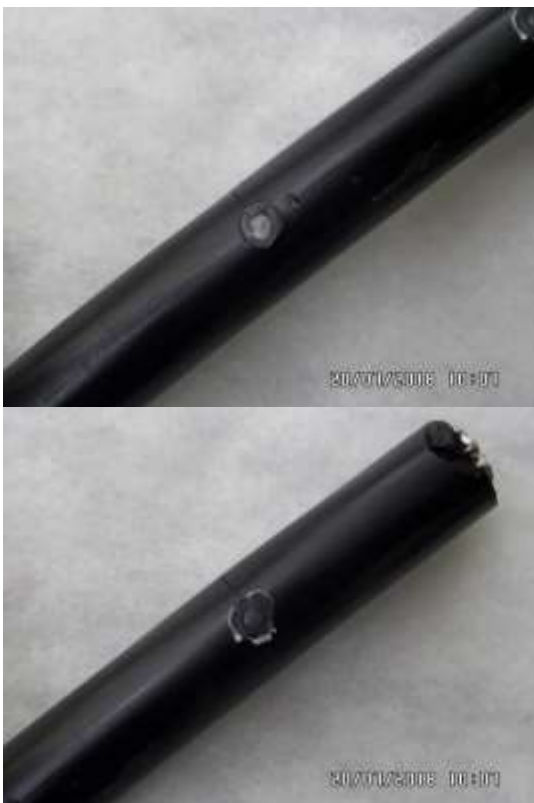
Рис. 4. Изоляция кабеля со сформированным швом за время 0,5 сек (сверху), за время 0,7 сек (снизу)
